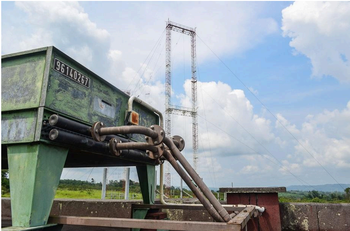
Imagem: Outra vista do sistema de refrigeração do centro de transmissão em Moyabi (Fotografia de Jean Baptiste Dodane)
