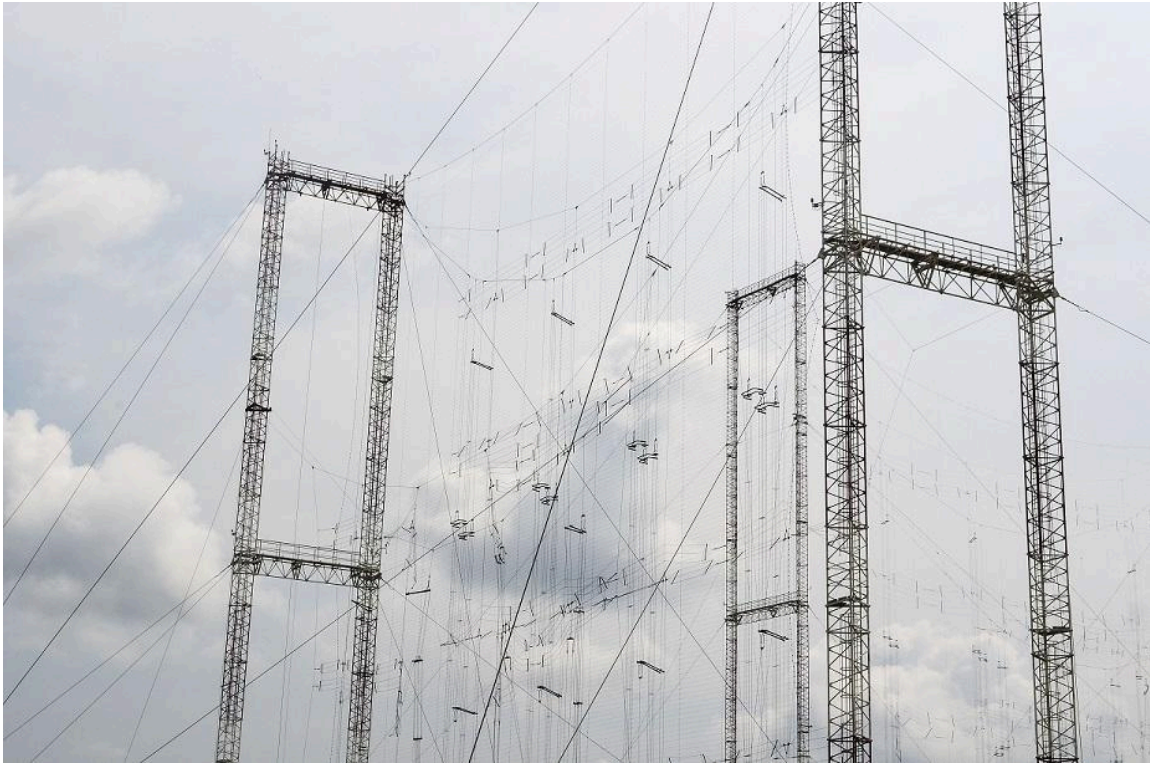
Imagem: A poderosa cortina de antenas dipolo do centro de transmissão em Moyabi, da Rádio África Nº1, vista de outro ângulo, podemos ver parte das torres formando uma cruz, com a finalidade de direcionar a potência irradiada para os 4 pontos cardeais (Fotografia de Jean Baptiste Dodane)
